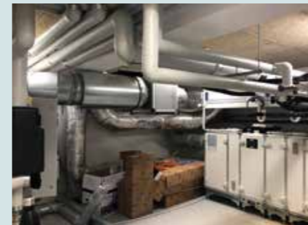
La chaufferie du musée.
